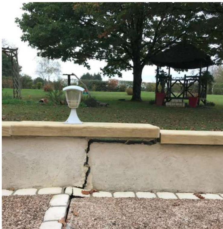
Exemple de dégât
