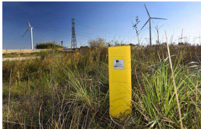
Borne de signalisation canalisation gaz
