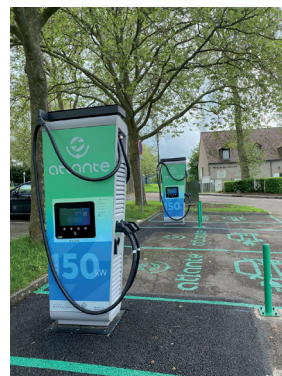
Bornes de recharges pour véhicules électriques nouvelles implantations
